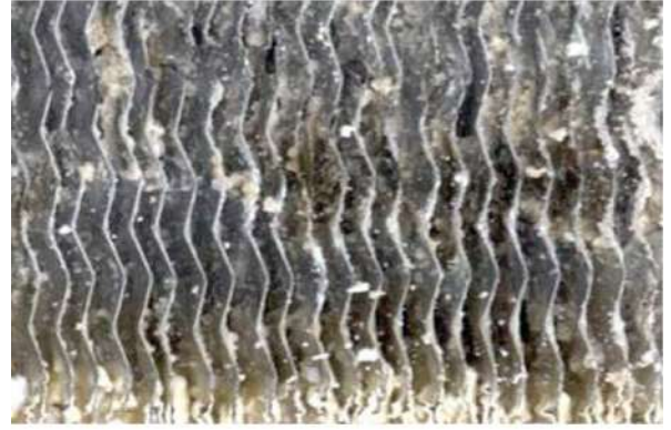
ŞEKİL 15: KAPLAMADA RENK BOZULMASI, KOROZYON KRİSTALLERİ, TUZ BİRİKİMİ, KANAT KENARINDA KOROZYON
